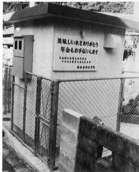
年金積立金の還元融資を受けて建設された中尾簡易水道（写真は中継ポンプ所）
