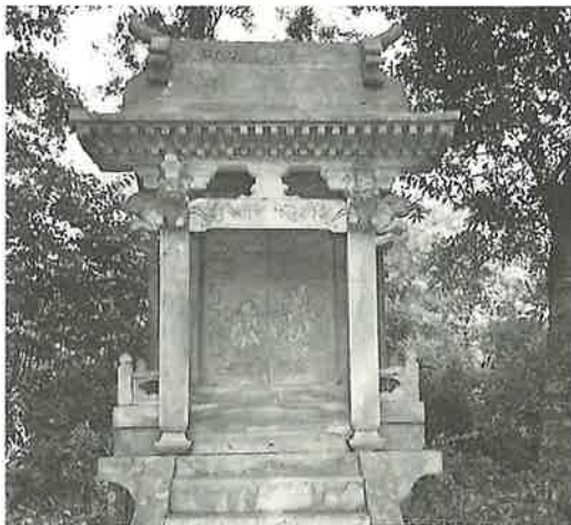
この石造神殿も永い歳月を経て、部分的に痛みがひどくなっていました。このため、今年5月に貴重な文化財を長く保存するための工事が行われました。
