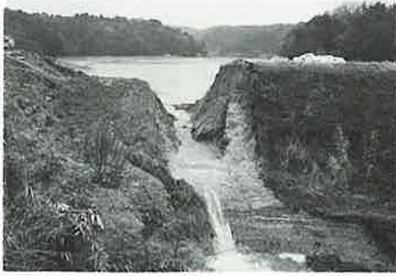
徹夜の作業で堤防が削り取られた
