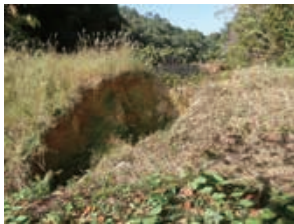
堤体が崩壊した「ため池」
