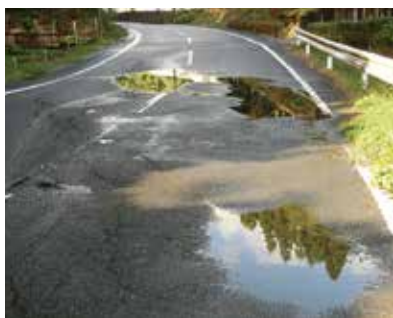
町道陥没箇所
