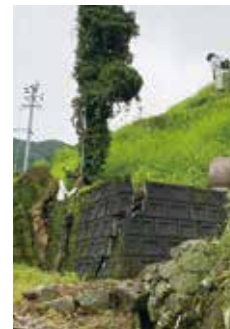
崩壊した法面(大鬼木地区)
