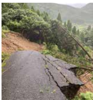
復旧が待たれる林道金屋線
