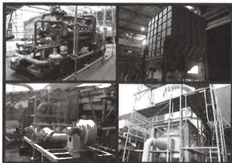
バイオマス発電プラント
