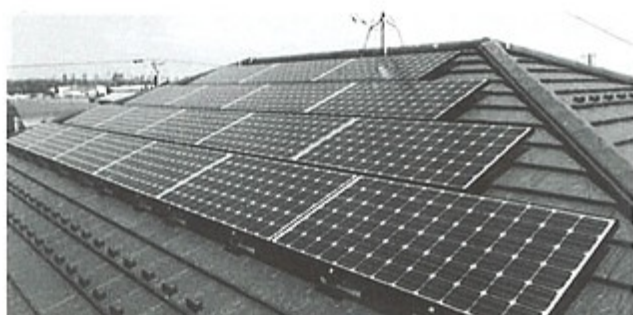
自然エネルギーを活用した太陽光発電設備
