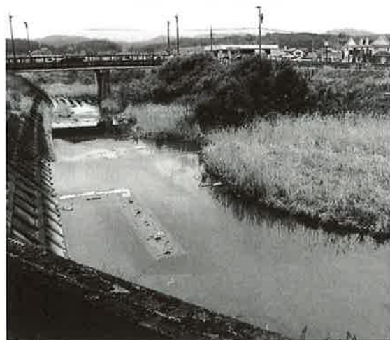
集水箇所付近の堆積土砂 (陣川ポンプ場)
