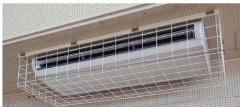
LP ガス発電による空調機
