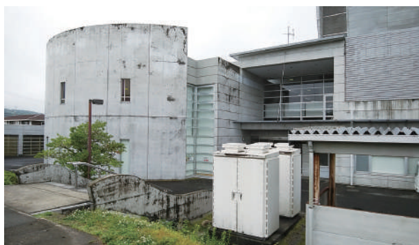
劣化している外壁
