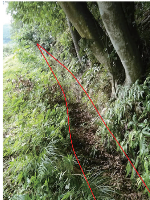
土砂や落葉で埋没している水路
