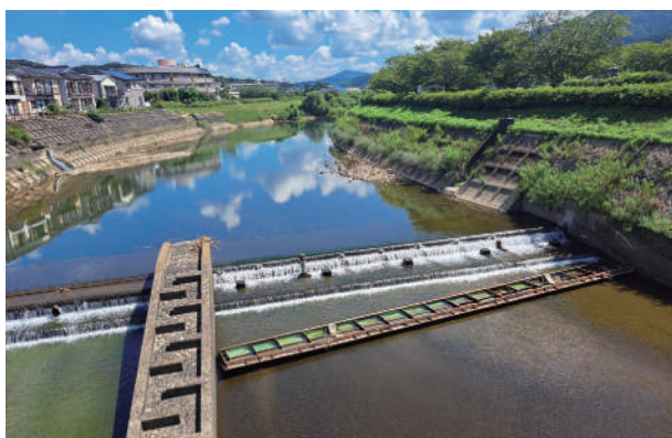
老朽化し壊れた堰板
