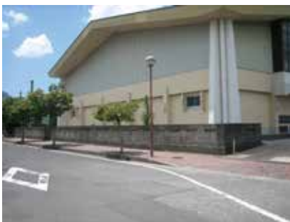
中学校体育館東側のブロック塀
