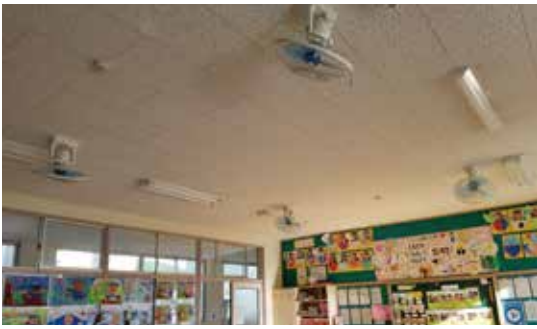
教室に設置された扇風機
