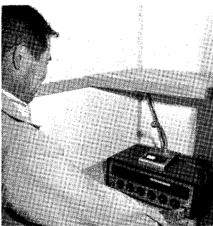
各戸に連絡できる有線放送施設
