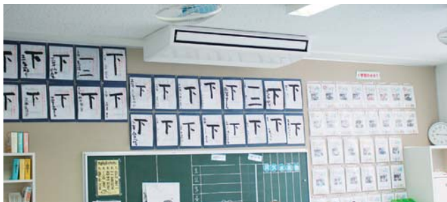
▲普通教室に設置している空調機
